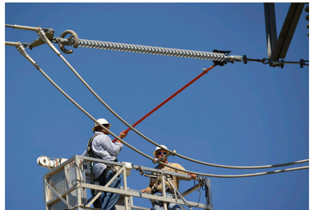
Test des isolateurs polymères sur ligne haute tension 345kV
